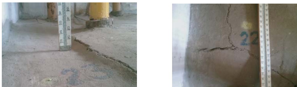
Рис. 4. Фото окремих тріщин та деформованих ділянок підлоги на об'єкті ГРП-1 (ділянки марок в23, в22)
