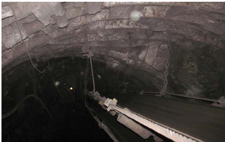
Рис. 2. Состояние участка южного уклона II ступени пл. I 1 в районе ПК56
